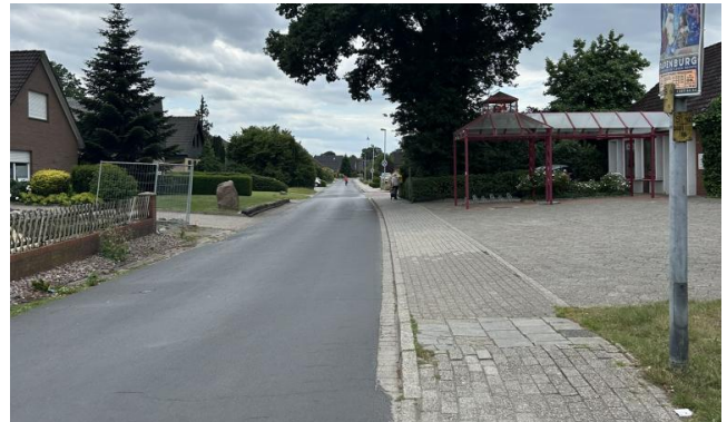
Schmaler Gehweg mit Querneigung und schadhafter Oberfläche entlang des Steinwegs in Flachsmeer.
