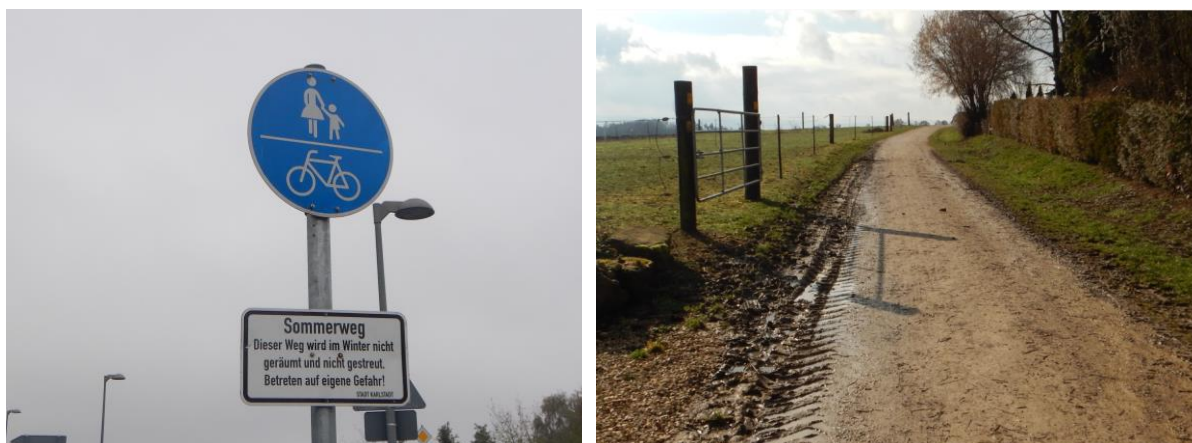
Abbildung 18: Sogenannter „Sommerweg“ im Landkreis Main-Spessart (links), verschmutzter (asphaltierter) Wirtschaftsweg (rechts) (Quelle: eigene Aufnahmen)
