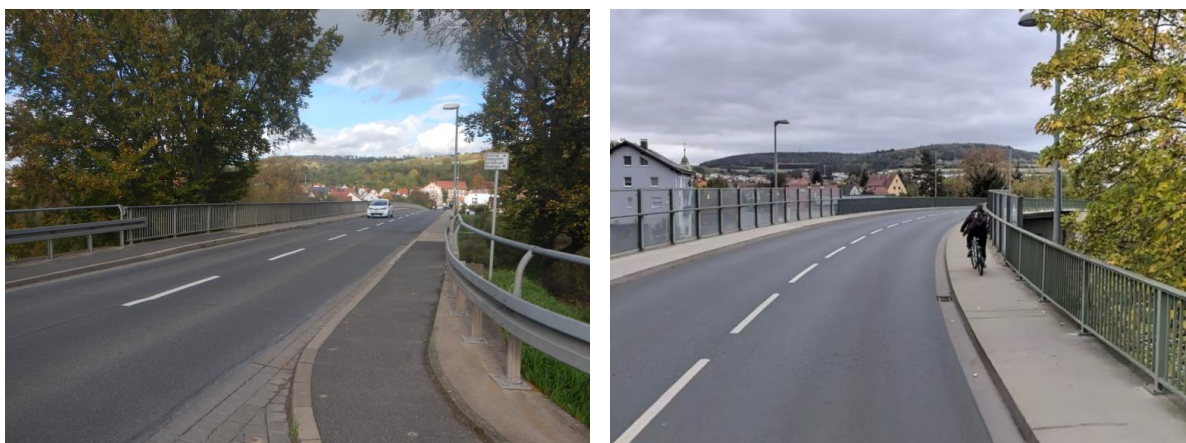
Abbildung 7: Brücke ohne Radverkehrsanlagen in Triefenstein (links) und Karlstadt (rechts) (Quelle: eigene Aufnahmen)
