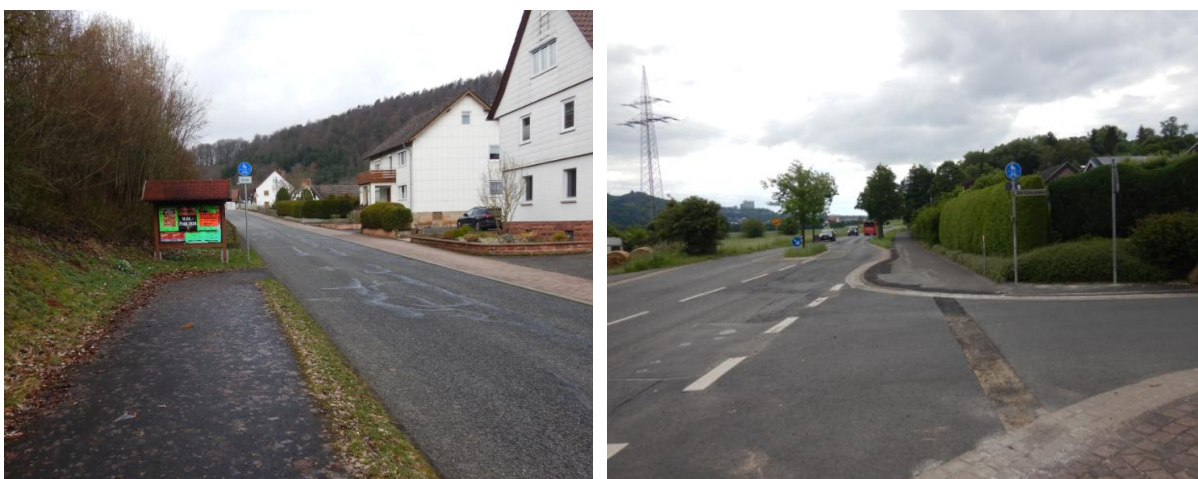
Abbildung 14: Ungeeignete Überführung auf die Fahrbahn am Ortseingang Kirchheim-Kemmerode (links) und am Ortseingang Rotenburg-Braach (rechts), (Quelle: Eigene Aufnahmen)
